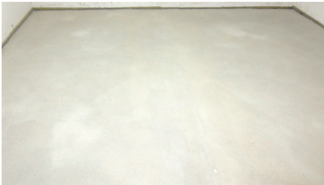
Abbildung A 2.5: Zementestrich (Prüfsituation)
